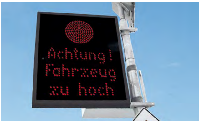
Höhenwarnanlagen sorgen für mehr Sicherheit.
