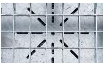
Wasserablauf am Boden des Clean-Cube.
